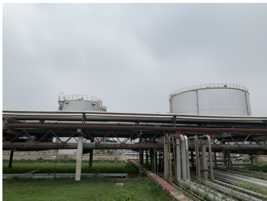
罐顶气联通照片
