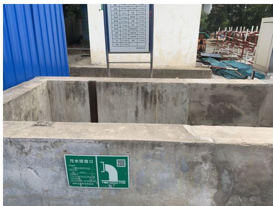
污水总排口标示
