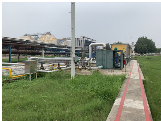
废气输送管道照片
