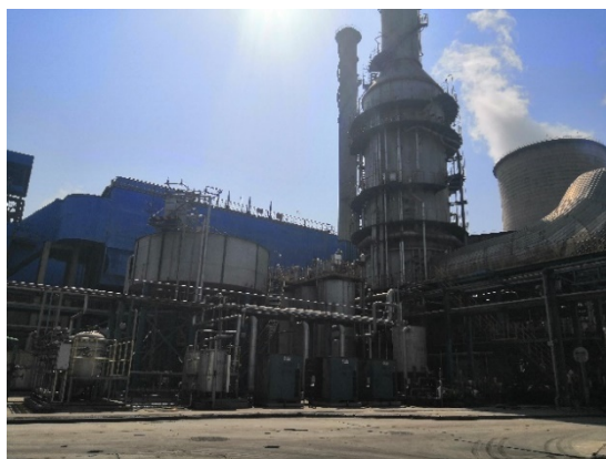
煤粉炉脱硫脱硝除尘系统照片
