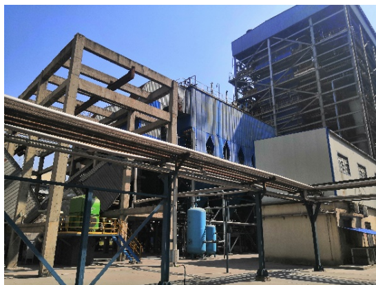
CFB锅炉脱硫脱硝除尘系统照片
