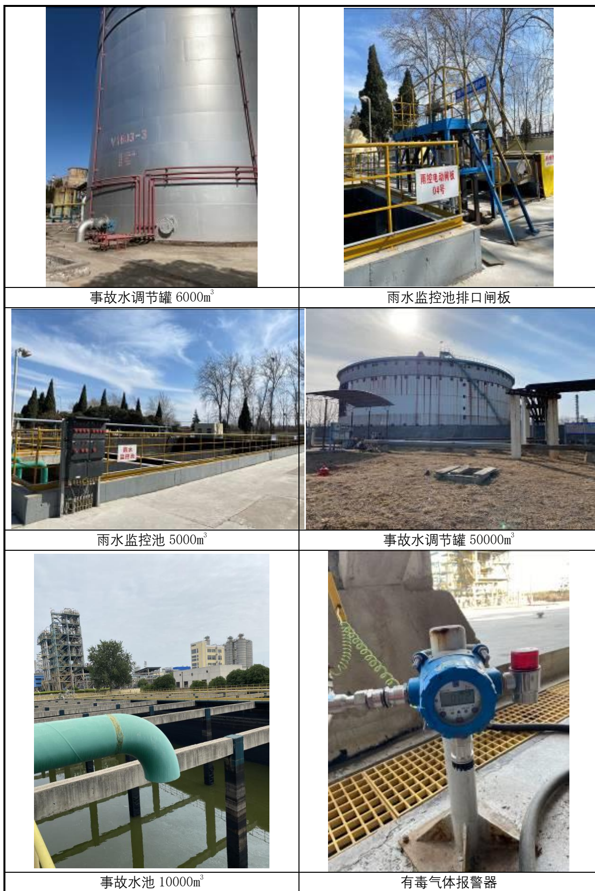
图 4.2-3 环境风险防范设施现场照片
