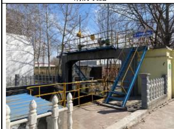
厂区雨排口闸板
