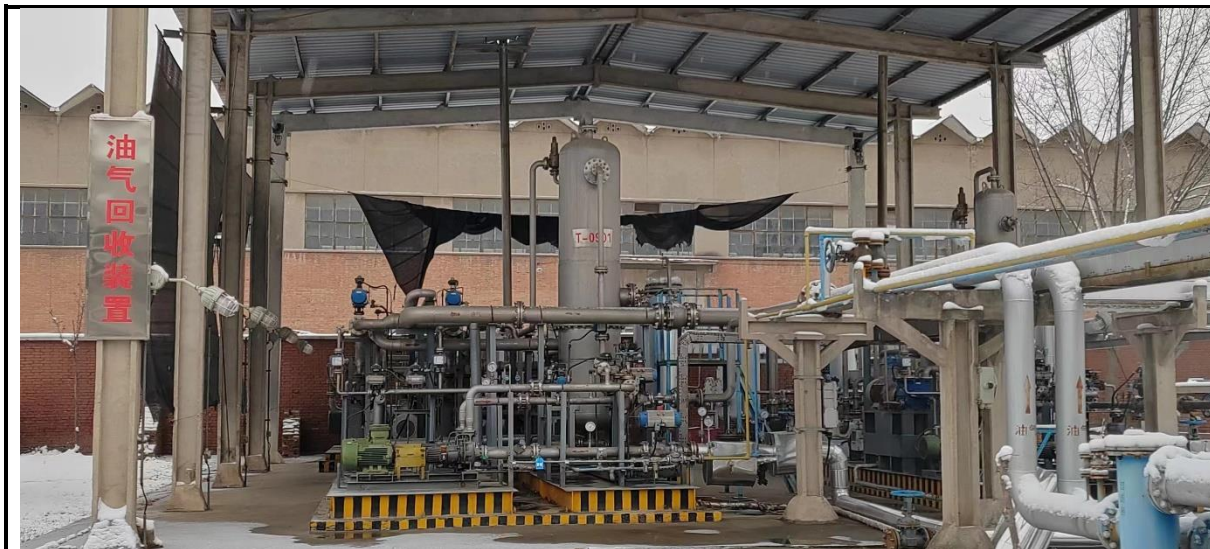
三苯装置油气回收设施
