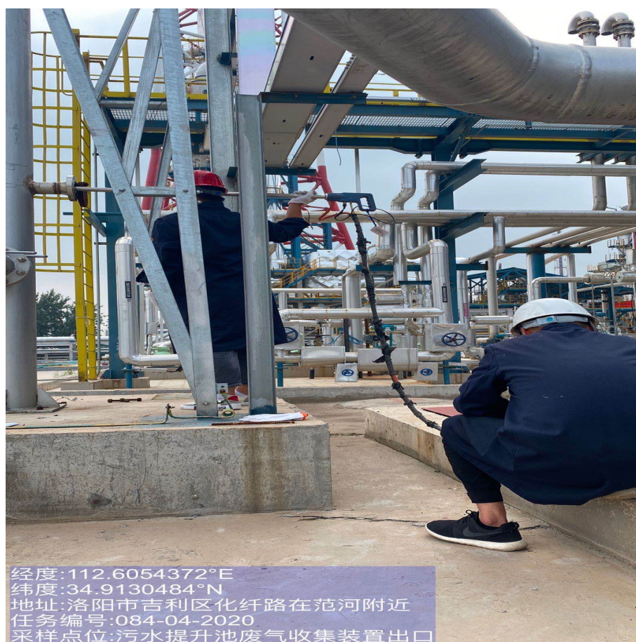
采样口及采样平台照片
