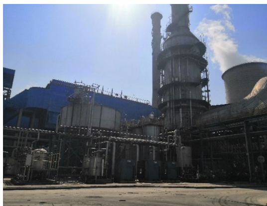
煤粉炉脱硫脱硝除尘系统照片
