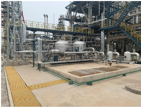
活性炭吸附罐照片
