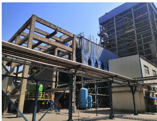
CFB锅炉脱硫脱硝除尘系统照片
