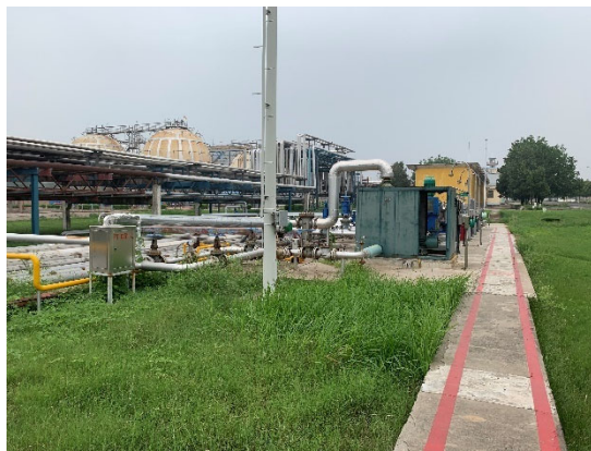
废气输送管道照片
