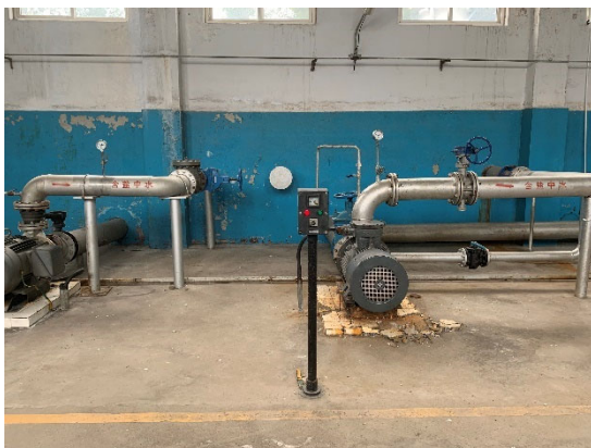
中水回用管道照片
