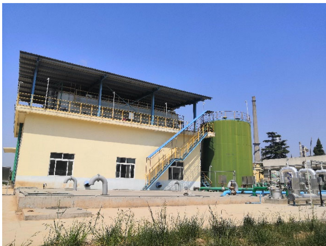
旁滤水处理设施照片
