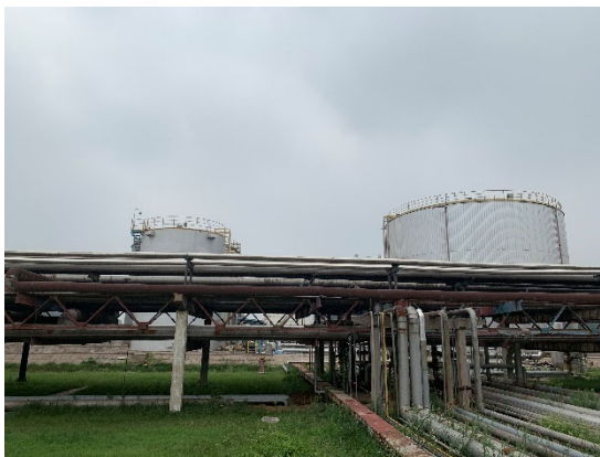
罐顶气联通照片
